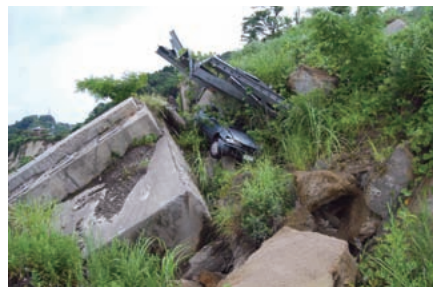
妙見：被害箇所がそのまま残る
