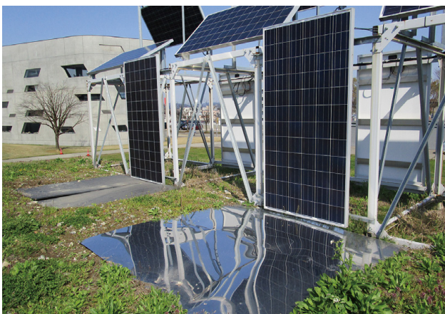
写真2：無反射板と反射板をおいた縦置きソーラーパネル
