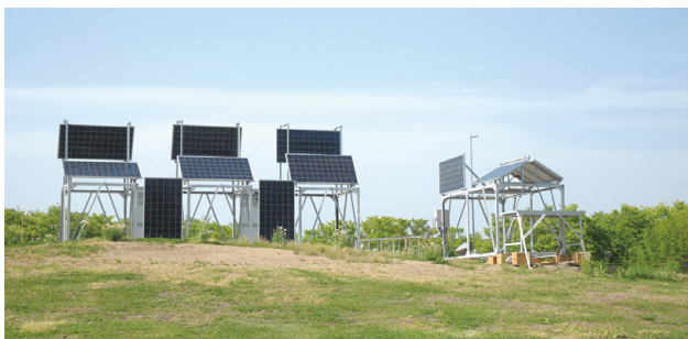
写真 1：ソーラーパネルの設置状況
